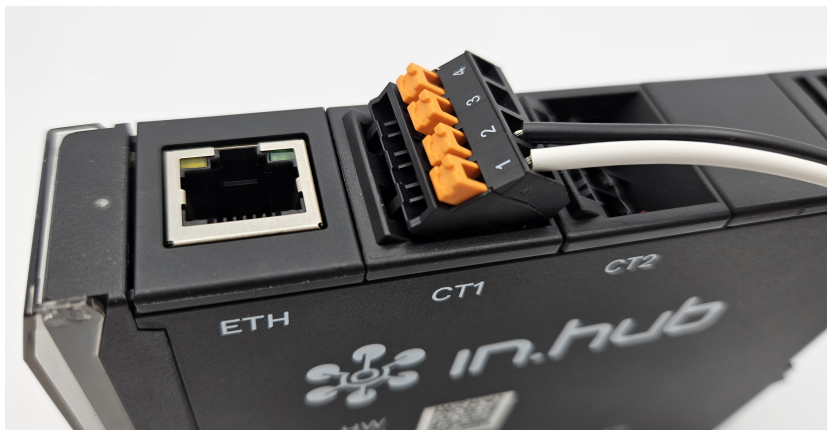
Anschluss eines SENS-CUR-Stromsensors am HUB-EN200
